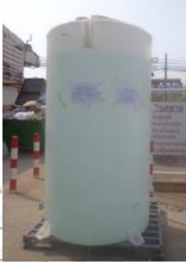
FeCl 3 Tank - 3m 3
